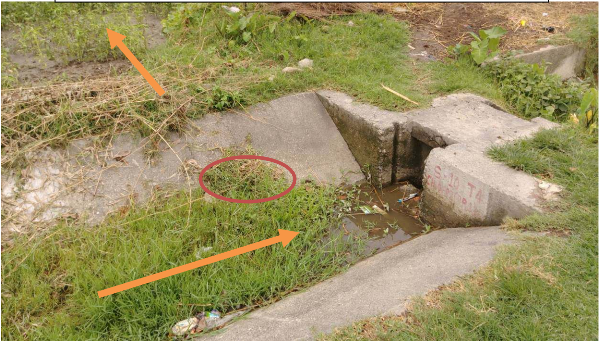
Pic.4: S10-T4, (Ch. 0+089), Damaged
